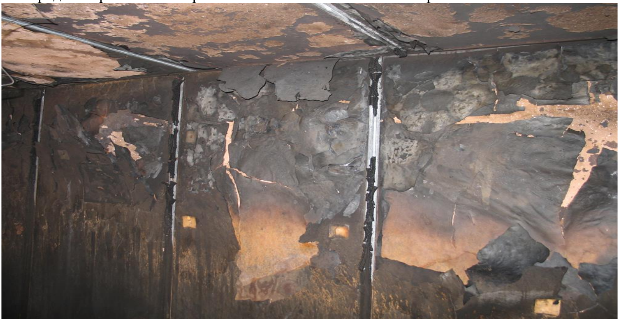
Фиг. 12 Поражения от пожара в помещение № 2
