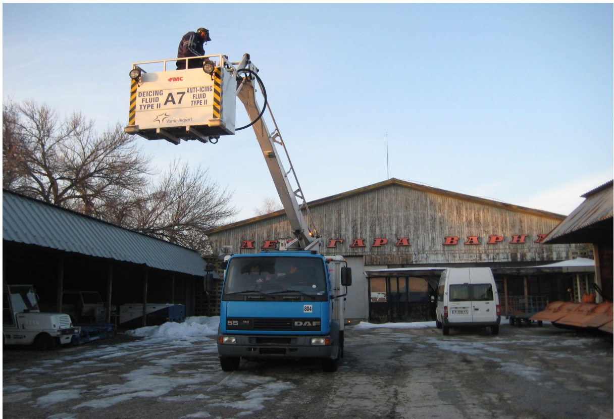
Фиг.6. Общ вид на автомобил SMD-1200 с вдигната стрела и оператор в коша.
