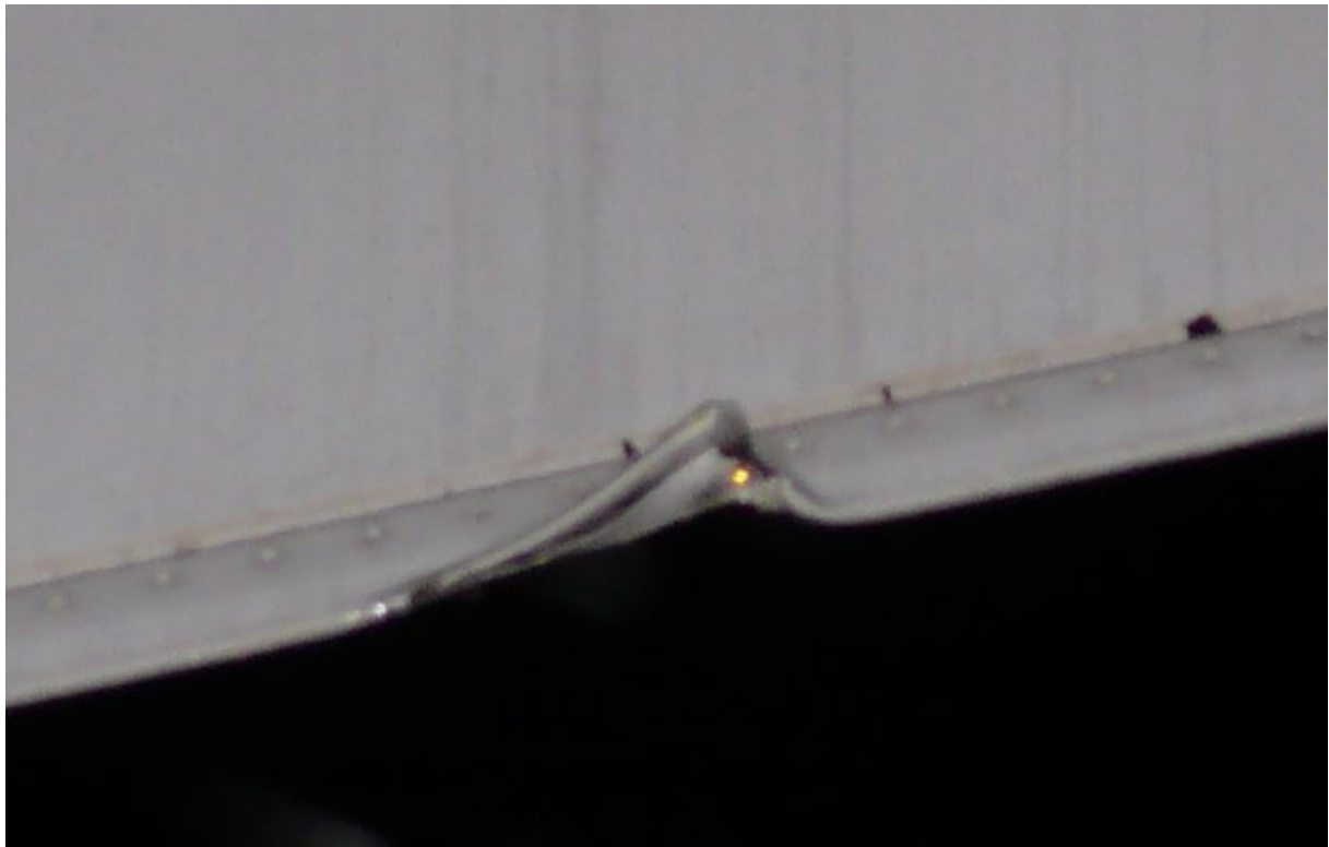
Фиг.3. Нанесена повреда по изходящия ръб на дясно хоризонтално кормило на самолет рег. знаци LZ-FBV (изглед от горе).
